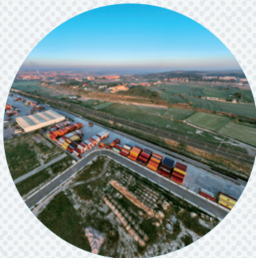
5 de junio Inicio de las obras de la segunda fase de ampliación para su transformación en terminal ferroviaria pasante.
